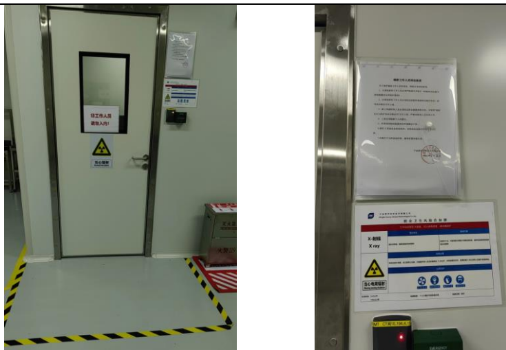
图4-1 CT室门口警示黄线、电离辐射警示标识、制度、密码锁
